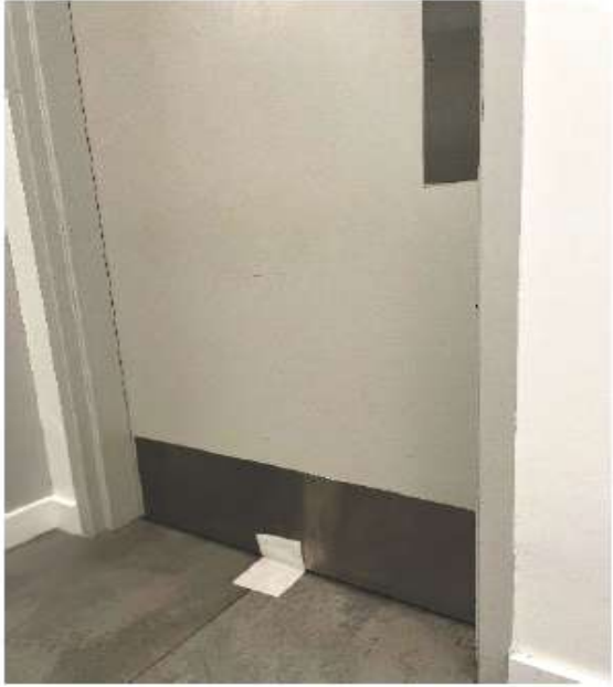
منظر من داخل غرفة الضغط الإيجابي.
